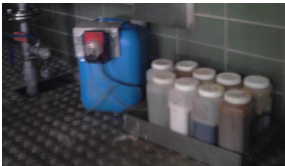
Foto 1 Dosierstation für EWT 21 (25 L Plastikgebinde und Jesco Schlauchpumpe)
